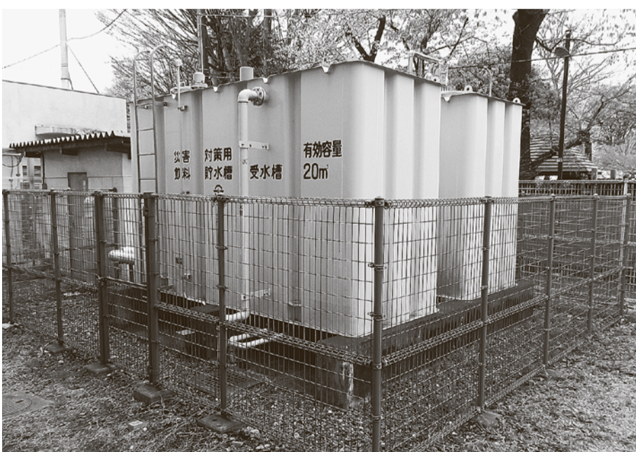
小・中学校に設置されている災害対策用の飲料貯水槽 (小平第三小学校)
