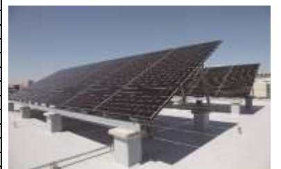
太陽光発電設備
