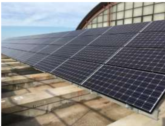
太陽光発電設備(市民総合体育館)
