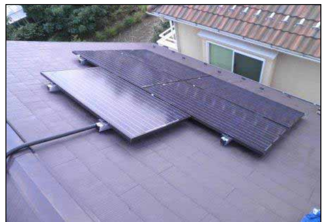
モニター助成により設置された太陽光発電装置
